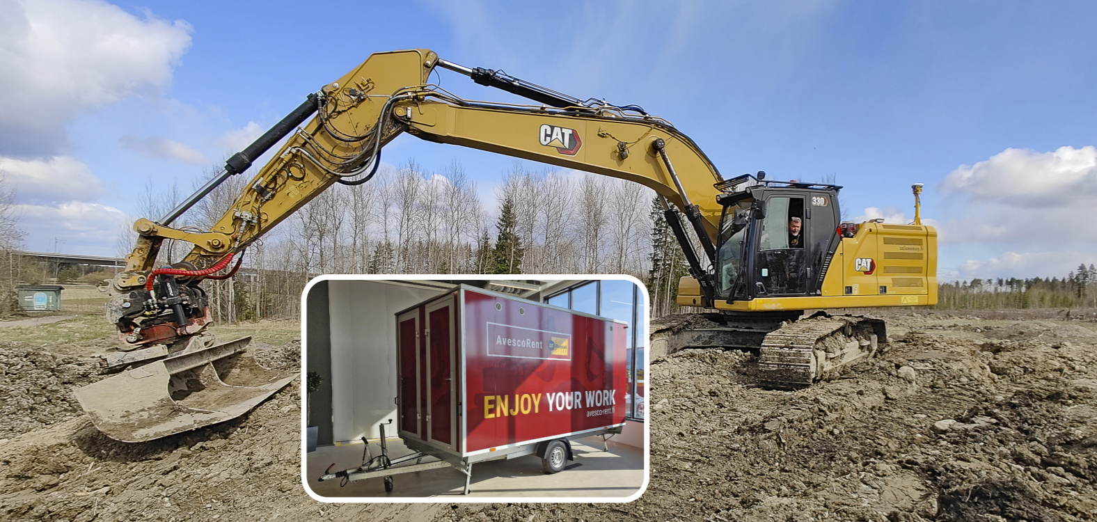
Avesco Rentiltä voi vuokrata laajan konearsenaalin lisäksi vaikkapa taukotuvan. Infratyömaan tarpeet pyritään nyt kattamaan mahdollisimman laajasti.
